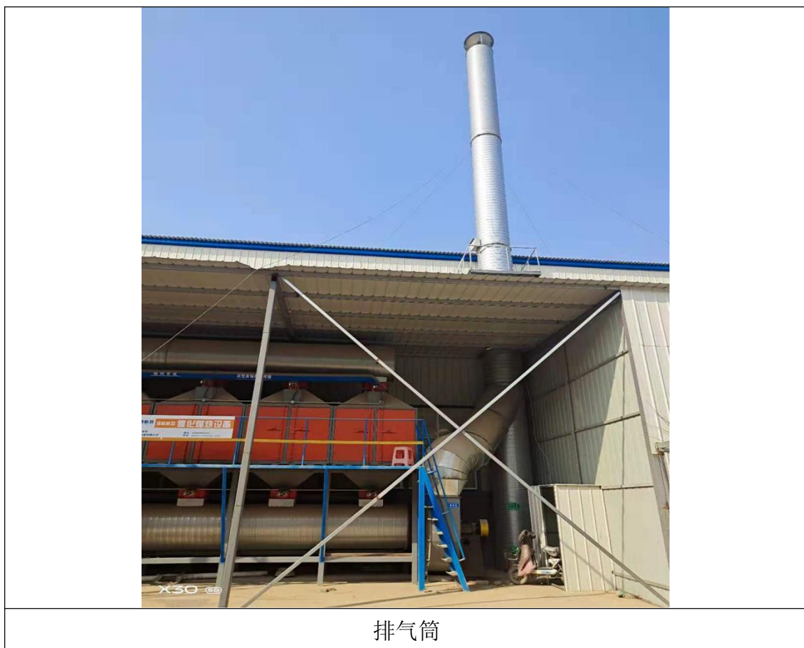
图 3-1 废气治理设施现场图
