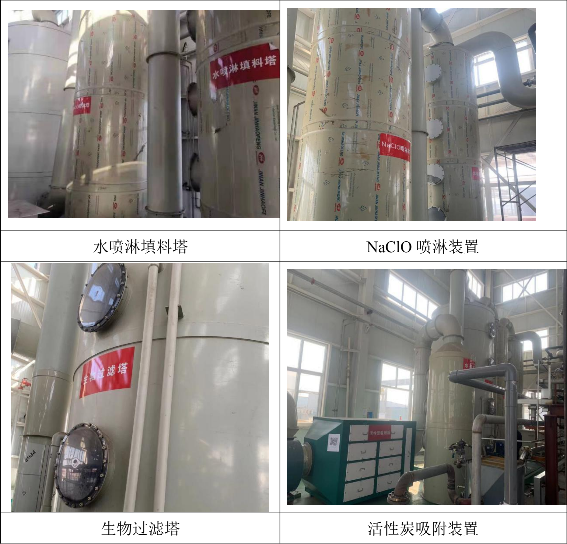
图 3-1 废气治理设施现场图
